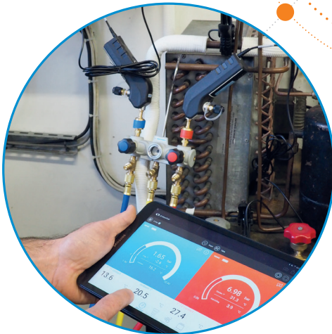
KONTROLLEN MIT DEM KOMBINIERTEN VERTEILER SI-RM13
